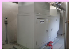
非常用発電設備
