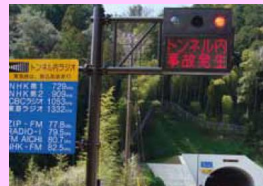
ラジオ再放送設備・警報表示板
