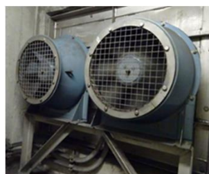
共同溝換気設備
