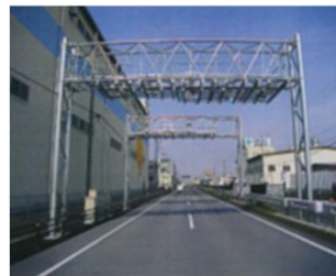
走行車両計測設備
