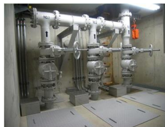
アンダーパス排水ポンプ設備
