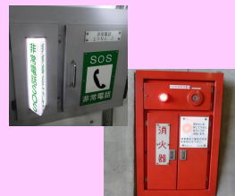
非常電話機・非常通報装置
