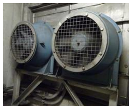
共同溝換気設備
