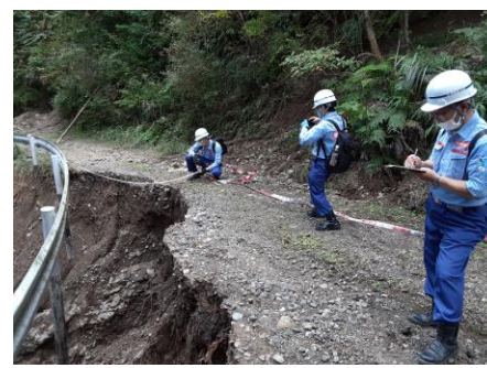
令和4年度 本川根町被災状況調査
