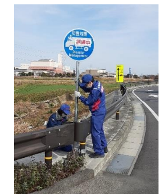
【防災拠点自動車駐車場の標識設置訓練の状況】
