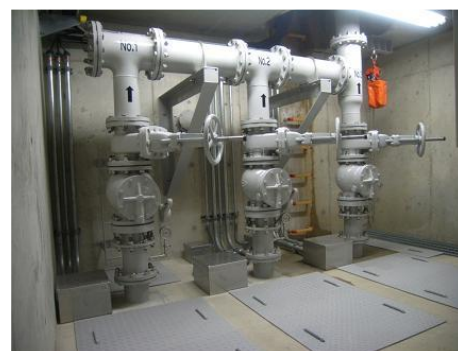
アンダーパス排水ポンプ設備
