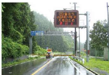
【通行止装置（遮断機）】
