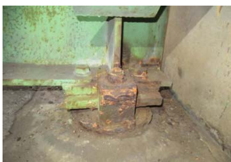
【橋梁支承部の腐食】
