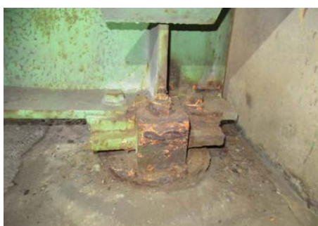
【橋梁支承部の腐食】
