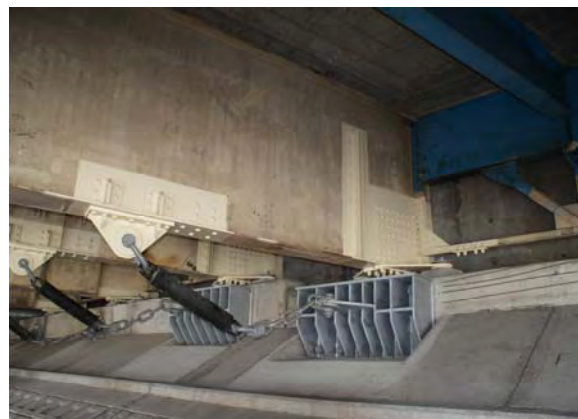
写真 落橋防止装置
