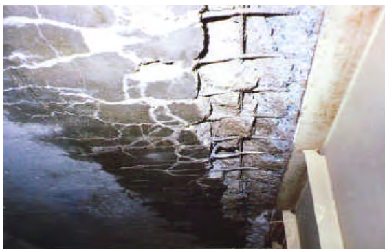
床版コンクリートの剥落
