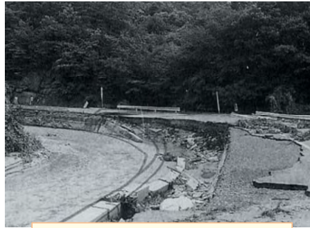
(1972年 7月の集中豪雨で被災した国道153号勤八地区)
