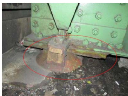
【橋梁支承部の腐食】
