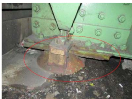
【橋梁支承部の腐食】
