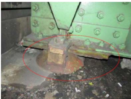
【橋梁支承部の腐食】
