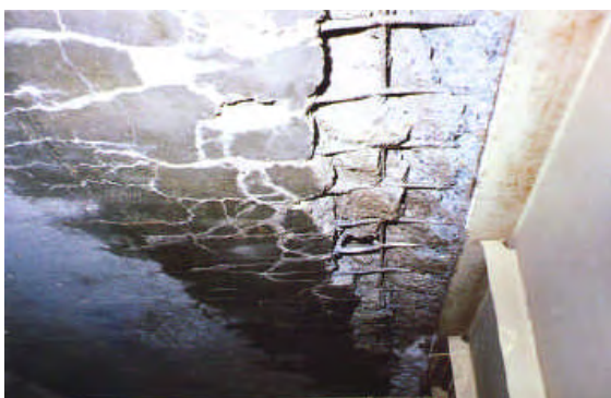
床版コンクリートの剥落
