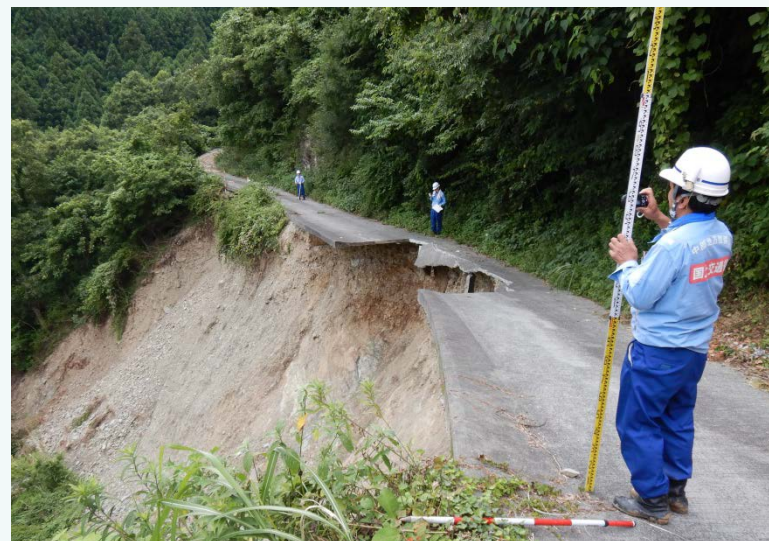
市道被災箇所での現地調査(7月12日愛媛県大洲市) 180718
