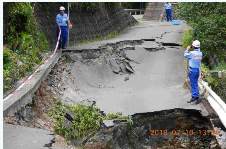
市道被災箇所での現地調査(7月10日愛媛県大洲市)
