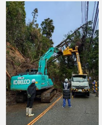
石川県穴水町 県道303号
