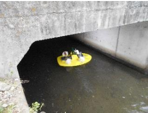
水上ドローンによる損傷把握
