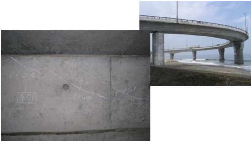
箱桁ウェブ面のひびわれ
