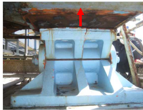
P2支承（固定）： 下弦材と上沓の間の溶接が外れ上部構造が移動
