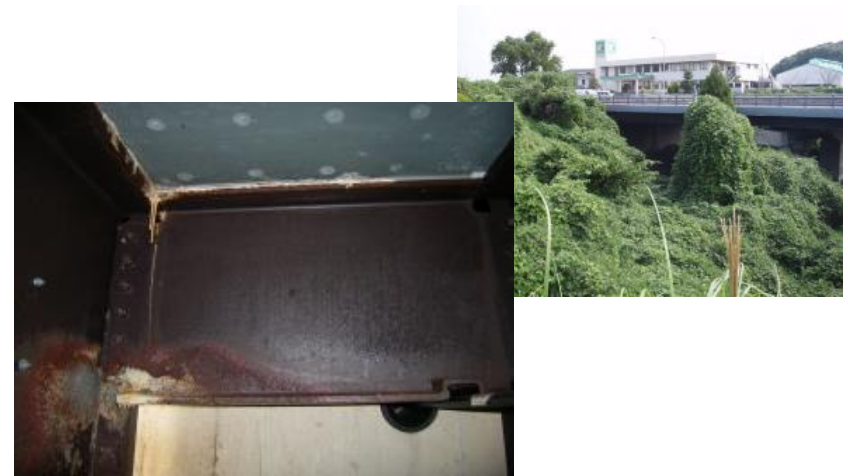
床版からの遊離石灰の析出
