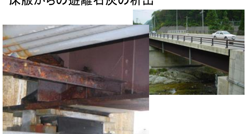
橋面排水の影響による腐食
