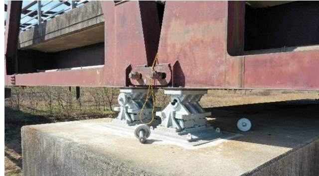
P3支承（可動）：ピンの脱落
