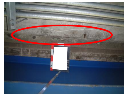
主桁の剥離・鉄筋露出
