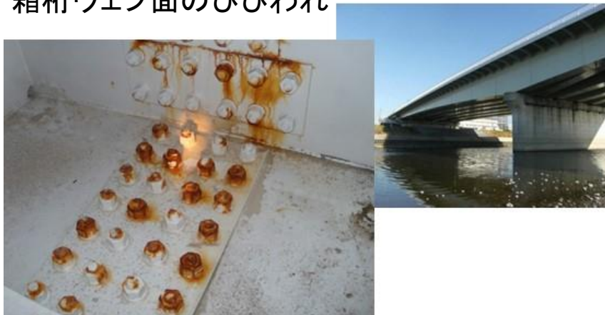
箱桁内のボルト部の腐食
