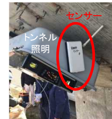
トンネル内附属物の異常監視センサー
