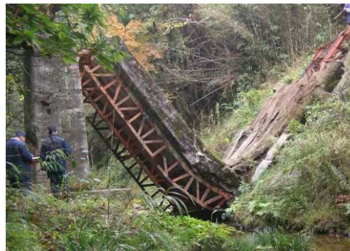
写真1 老朽化が原因で落橋した国内事例
