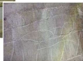
下部工のひび割れ
