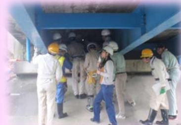
主桁の損傷等を確認
