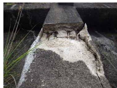
法枠工の老朽化損傷
