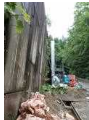
写真 壁面の傾斜の例
