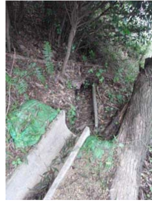
写真 排水溝の破損の例
