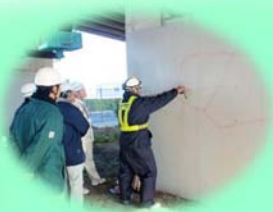
ひび割れ長さを現地に記録
