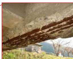
主桁の剥離、鉄筋露出
