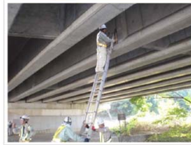
打音検査にてうき部、健全部を確認
