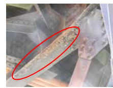
耐候性鋼材に層状の剥離
