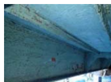
桁の塗装劣化やさびの発生
