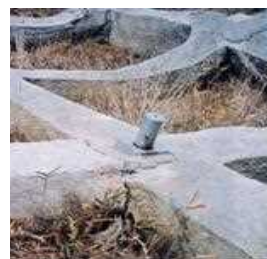
写真 受圧構造物の破損の例
