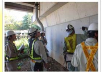
ひび割れ幅を現地に記録
