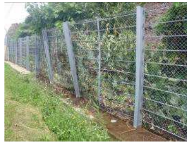
写真 落石防護柵の傾動の例
