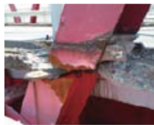
破断した鋼材、上下が完全に分離している
