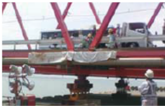
破断が発見された翌日に緊急対策工事に入っ
