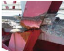
破断した鋼材。上下の両方に分離している
