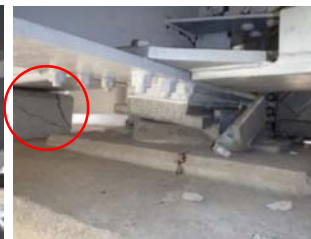
写真-6 支承の破損の状況
