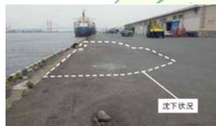
■ 岸壁エプロンの沈下(金城ふ頭)
