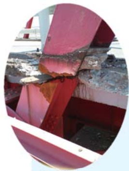
■ 橋梁の損傷(木曾川大橋)
