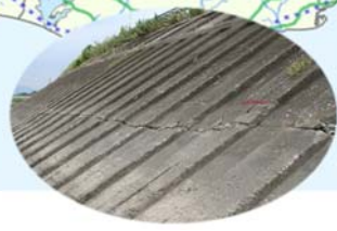
■ 護岸の老朽化(豊川)
