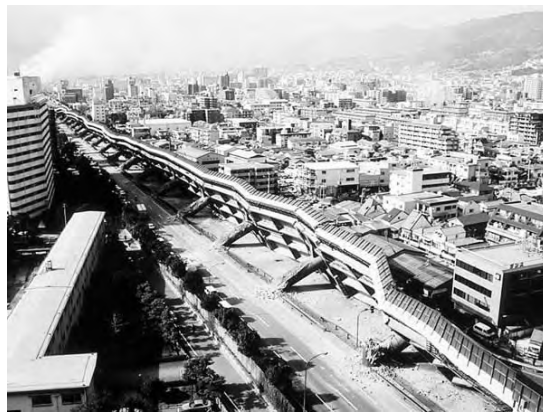
阪神大震災で倒壊した高速道路
