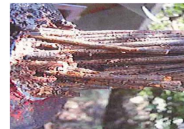
腐食でケーブル破断 吊橋のメインケーブルが破断
