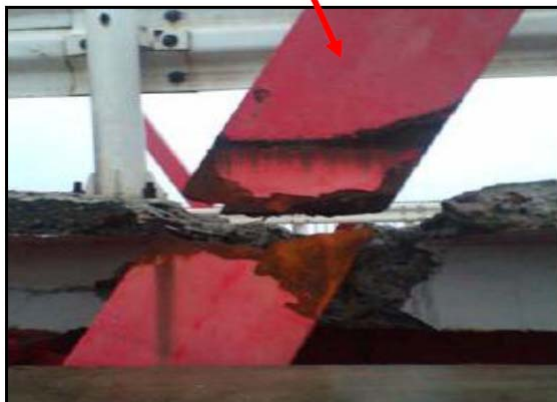
腐食で破断 2007年6月にトラス橋の斜材が破断
