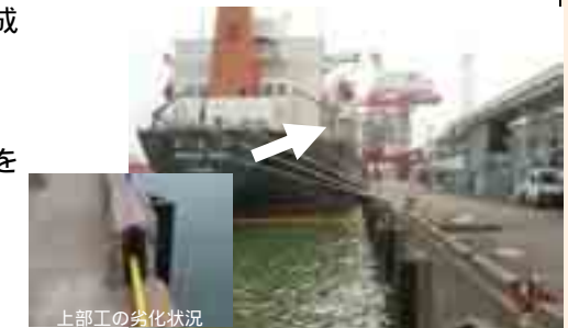
上部工の劣化状況 田子の浦港(多目的国際ターミナル)
