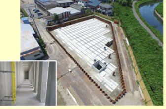
雨水(地下)貯留施設整備 (木曾川水系揖斐川、大垣市) イメージ
