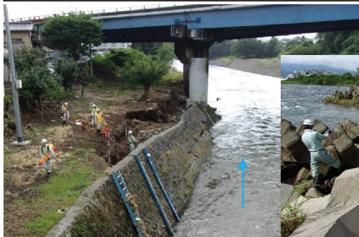
R3.7出水による被災状況。被災状況、被災規模等を現地で確認
