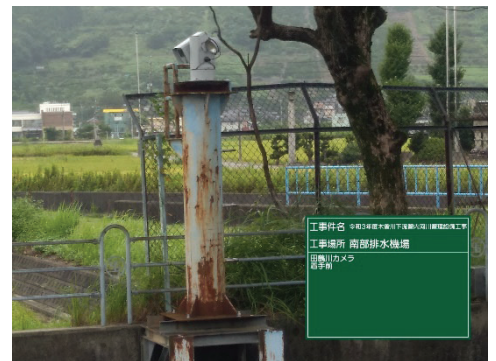
工事件名 令和3年度木曽川下流管内河川管理設備工事 工事場所 高須輪中排水機場 現場写真 実施状況 木門カメラ
