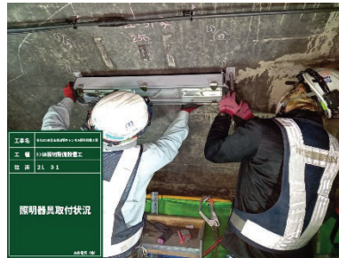
照明器具取付状況
