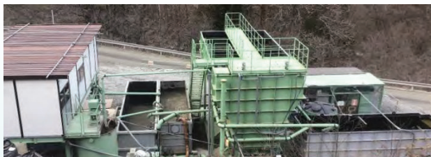
仮設備 (濁水処理プラント)
