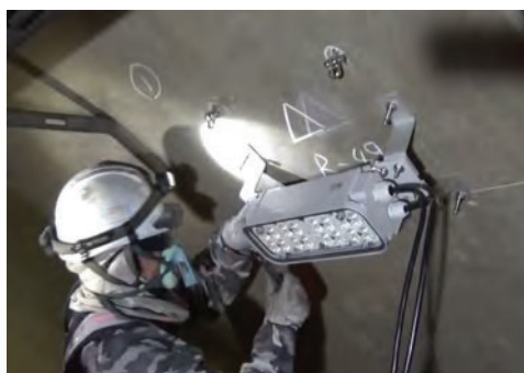
LEDトンネル照明器具 取付状況
