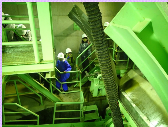
10月29日 2017秋の小里川ダム湖周ウォーキング コース途中でダムのゲート見学 (庄内川河川事務所)
