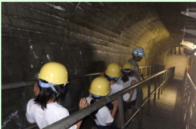
6/27 大鹿村小学校4年生の小渋ダム見学① 小渋ダム内部を探検する様子 (天竜川ダム統合管理事務所)
