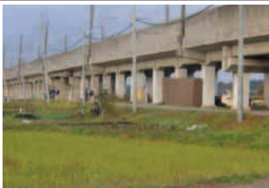
写真 鉄板巻きコンクリートで予め補強してあった高架橋の橋脚
