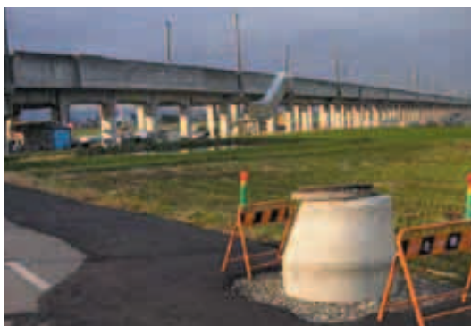
写真 地盤の液状化で浮き上がったマンホール
