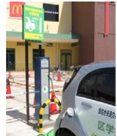
店舗駐車場の充電設備 写真提供：愛知県
