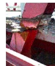
木曽川大橋鋼材破断 出典:中部地方整備局資料
