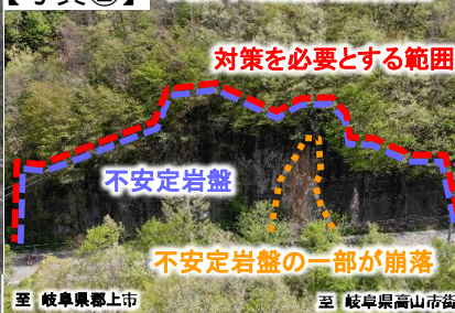
【写真②】 令和8年5月撮影(被害状況)
