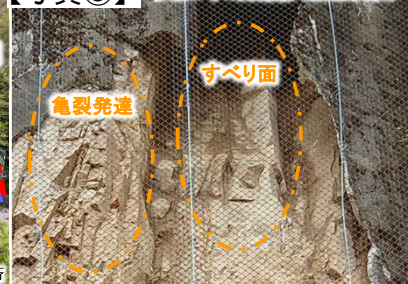
【写真③】 令和8年5月撮影(被害状況)
