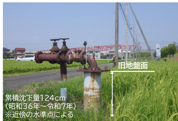
井戸管の抜け上がり状況(令和8年7月撮影) (三重県桑名郡木曽岬町)
