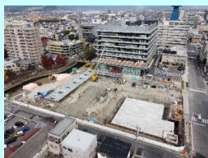
雨水調整池の整備 (大垣市役所新庁舎:大垣市)
