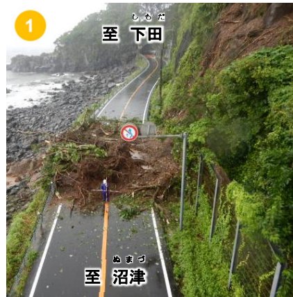
【国道135号 法面崩壊】 (令和2年7月 伊東市赤沢)
