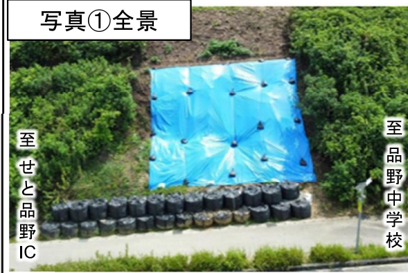
写真②被災状況
