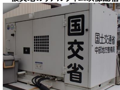
照明車に搭載された発電機
