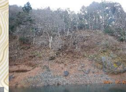
変状箇所-14(中野双里) (法面崩落状況を確認)
