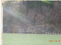
変状箇所-1(法面崩落状況を確認)
