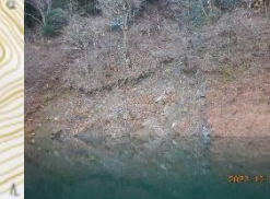
L7.4km付近(河川巡視時も確認) (法面崩落状況を確認)
