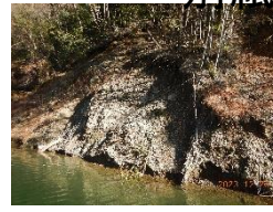
八橋小道下(法面崩落状況を確認)
