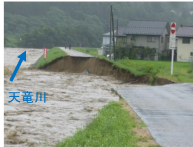
平成18年7月豪雨河岸浸食状況
