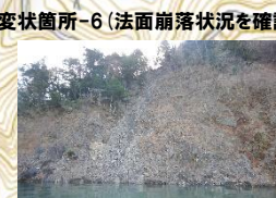
変状箇所-6 (法面崩落状況を確認)
