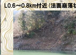
L0.6~0.8km付近 (法面崩落状況を確認)
