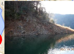
L3.4km付近 (法面崩落状況を確認)
