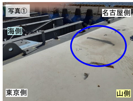
写真①橋桁上フランジに凹み
