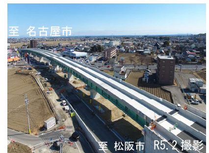
令和5年度開通に向け工事が進む 中勢道路 北玉垣高架橋付近
