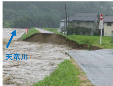
平成18年7月豪雨河岸浸食状況
