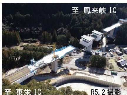
至 鳳来峡 IC 至 東栄 IC R5.2 撮影 令和7年度開通に向け工事が進む 佐久間道路・三遠道路 鳳来地区
