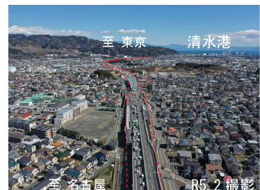
R8年春頃開通に向け工事が進む 静清バイパス（清水立体）
