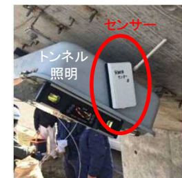
トンネル内付属物の 異常監視センサー
