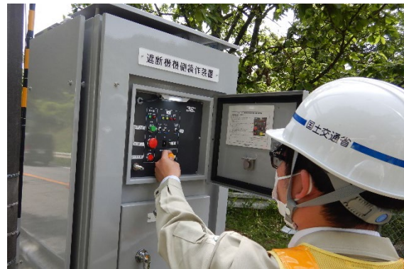
操作盤を確認
