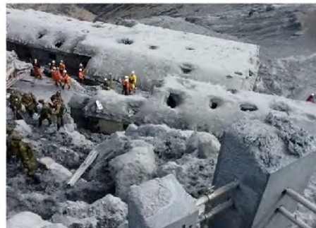
噴石で穴の開いた山小屋の屋根
