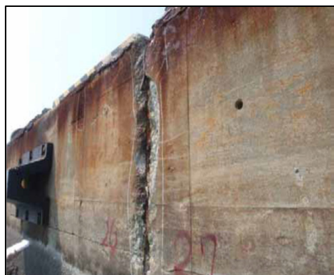
上部工の劣化状況
