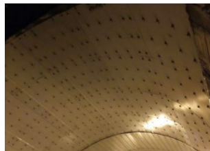
▲ アンカーボルトにより固定された鋼板(ボルトの取付異常により落下が懸念)
