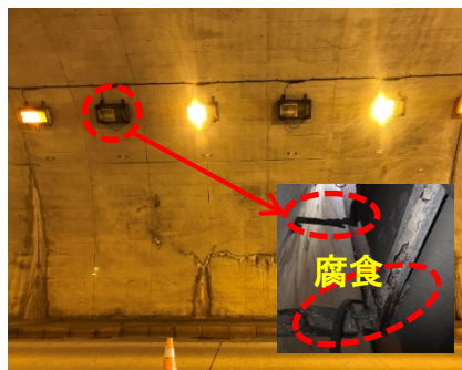
▲ 附属物取付部の腐食
