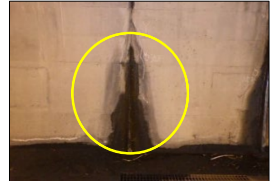
【覆工からの漏水】
