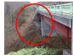
斜面上基礎の洗掘
