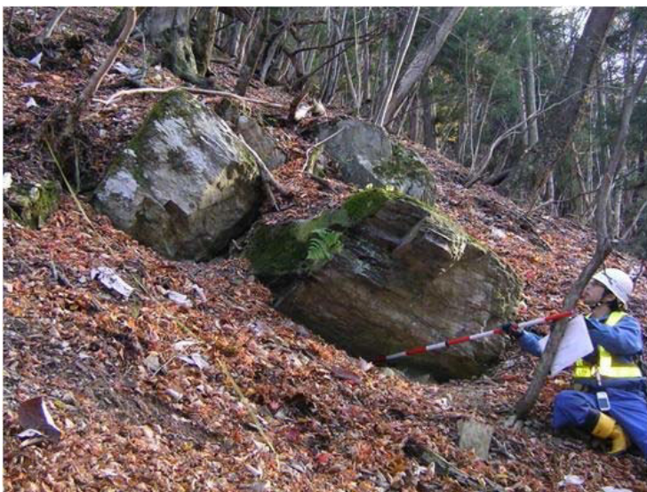
写真①: 要対策箇所 (岩石崩壊)
