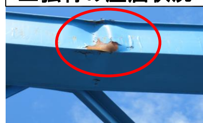
上弦材の座屈状況
